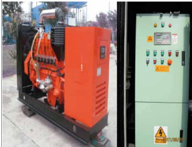
Figura 10. MCBP. Sistema de cogeneración
