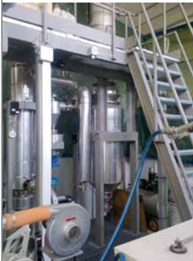
Figura 8. MCBP. Recuperador de calor
